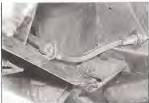
FREINS. Faites les contrôles standard sur l'état des garnitures et celui des cylindres de roues. Attention, les flexibles se détériorent par l'intérieur. Ce n'est pas visible, mais on s'en aperçoit si après un coup de frein la voiture a du mal à rouler (la pression ne revient pas), ou si elle freine de travers. Changez toujours les flexibles par paire (les deux flexibles du même essieu). Contrôlez également l'étanchéité du maître-cylindre, au niveau de la tige de poussée de la pédale de frein.
