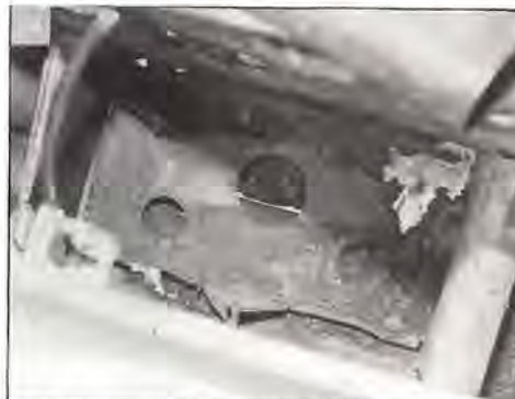
BAC A BATTERIE. Là aussi, il y a de gros soucis de corrosion. Vérifiez que votre batterie est bien arrimée, qu'elle n'est pas trop remplie, que l'acide n'a pas débordé. Il n'est jamais trop tard pour procéder à une protection préventive en appliquant de l'antirouille.
