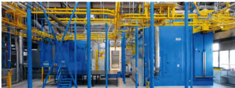
Pulverbeschichtungsanlage / Chemische Vorbehandlung
