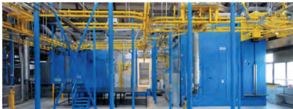
Pulverbeschichtungsanlage / Chemische Vorbehandlung
